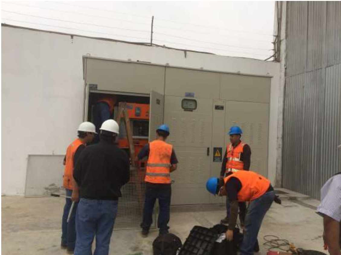
SUBESTACION DE 1250 KVA MONTADA LISTA PARA PUESTA EN SERVICIO.
