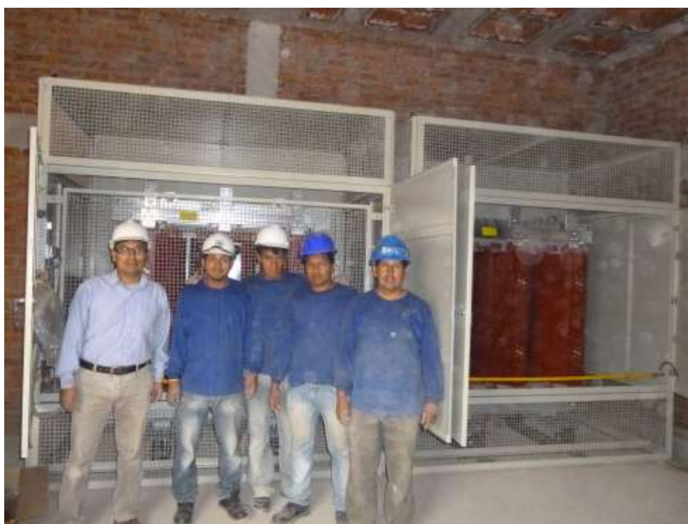
SUBESTACION DE 2500 KVA, LADRILLOS PIRAMIDE
