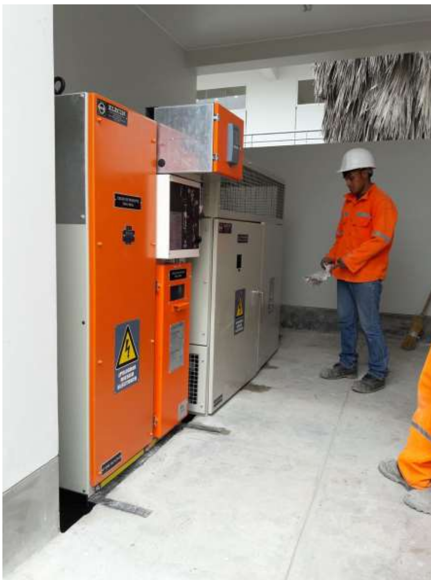
SUBESTACION DEL COLEGIO DE MUJERES - CAÑETE
