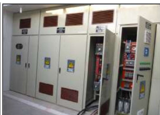
SUBESTACIÓN CONVENCIONAL CON COMPENSADOR REACTIVO
